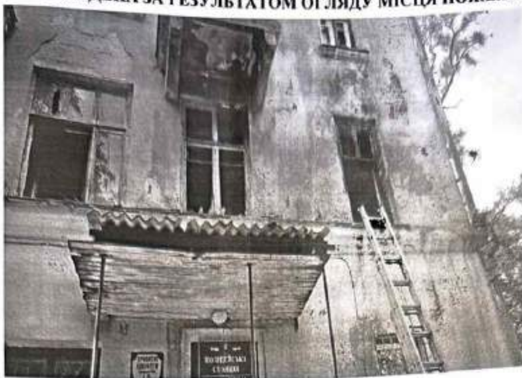
Фото №1 Загальний вид будинку, де виникла пожежа
